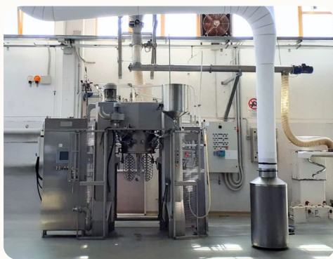
Impianto a dislocamento realizzato da ATS2000 per l'industria alimentare - stabilimento produttivo di confezionamento prodotti da forno.
