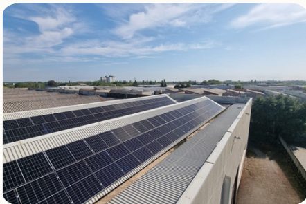
Impianto fotovoltaico 74kWp realizzato da ATS2000 per un'azienda di packaging del parmense
